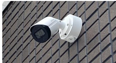
防犯カメラ設置 現場写真
