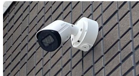
防犯カメラ設置 現場写真
